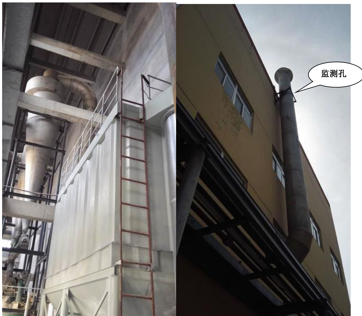
图 3.1-7 氰尿酸粉碎废气处理措施及排气筒（1#）
