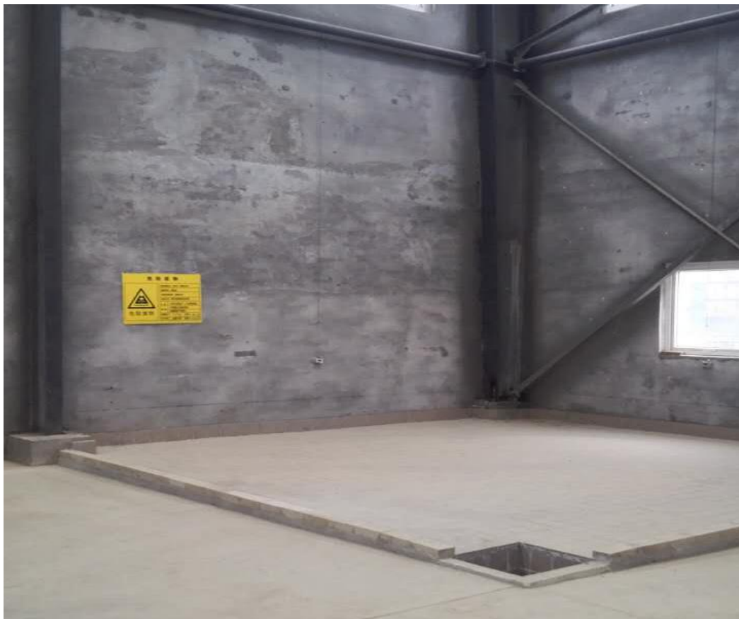
图 3.1-14 危险废物暂存设施图
